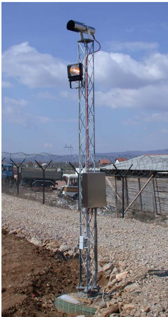
Figur 2.3 Fagverksmast i Kosovo påmontert kamera, lys og kamerakontrollboks.
